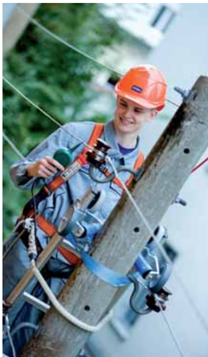
Bei ENSO geht es als Elektroniker – Betriebstechnik schon mal hoch hinaus.
