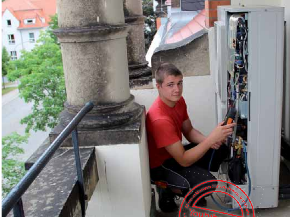
Tobias Mühle bei der Wartung von einer Klimaanlage
